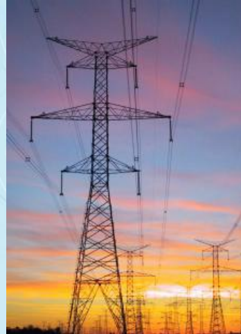
Líneas de Transmisión
